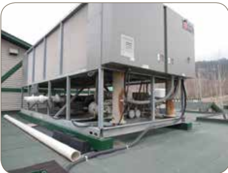
Fan cooler void space
