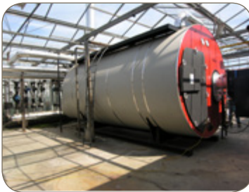
溫室內的鍋爐
