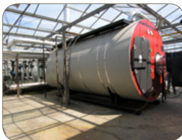
温室内的锅炉
