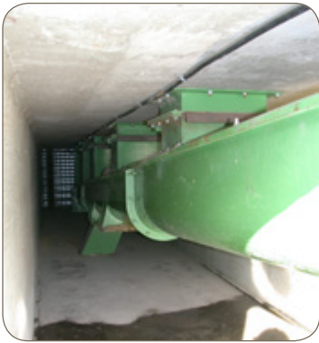
Băng truyền tải trong đường hầm
