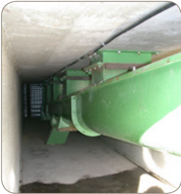
터널 안 컨베이어
