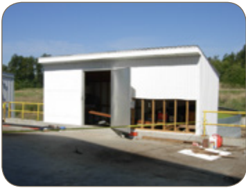
Cobertizo de bombeo
