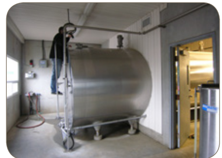
Tanque de leche
